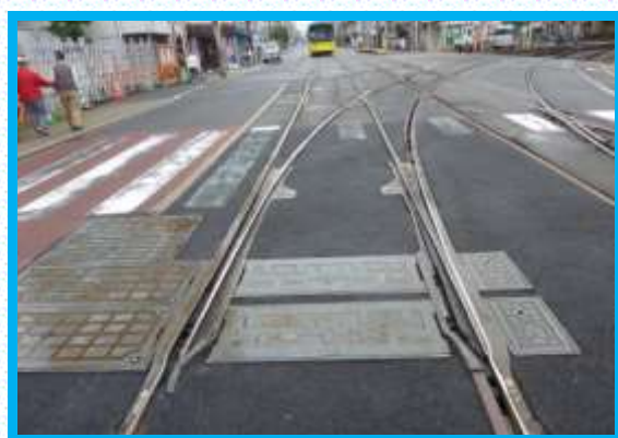
● 更新した電気転轍機(住吉 12M)
